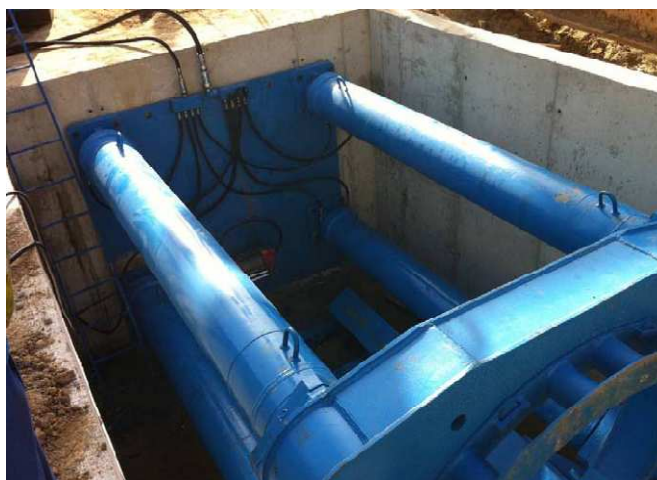
Vista de los cilindros hidráulicos.
