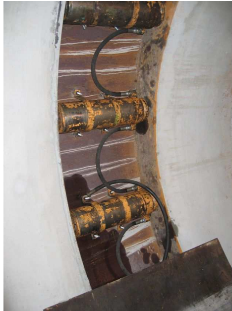
Imagen del detalle de una Estación Intermedia.
