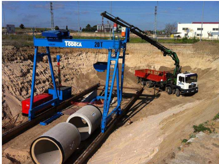
Vista del puente grúa y la colocación de los equipos.
